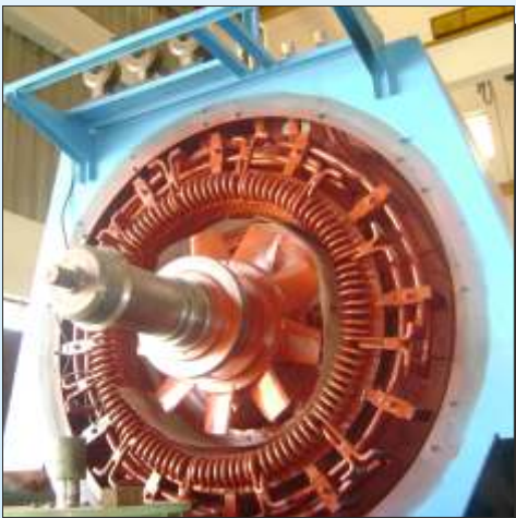
10MW, 11KV, Motor
