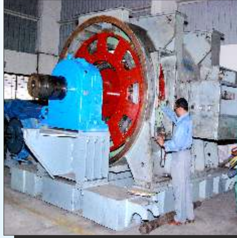
12MW, 11KV, Motor
